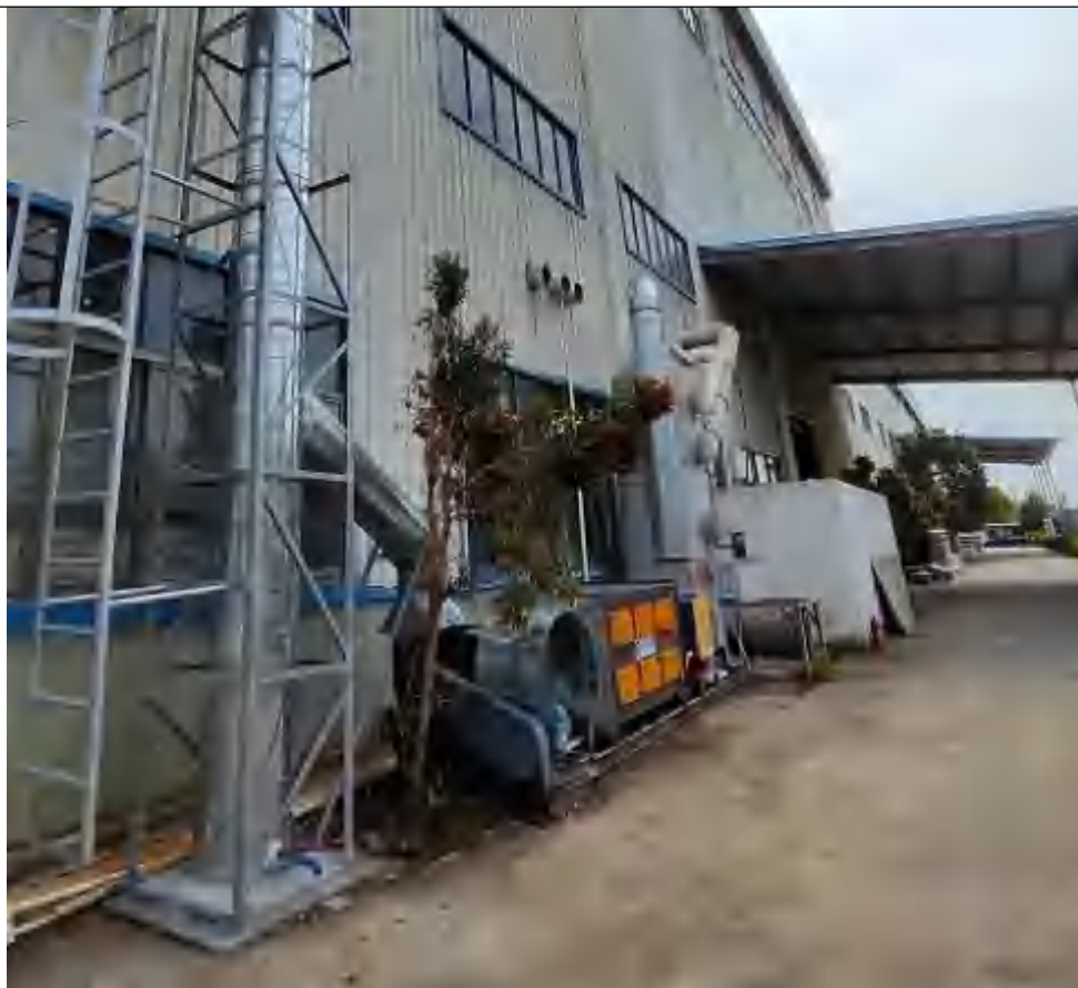
1#“水喷淋、除雾+活性炭吸附”设施（排放口 DA001）
