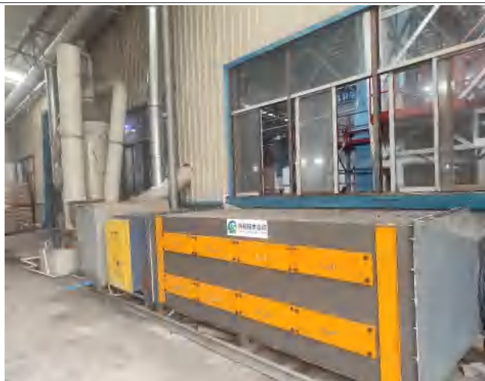
2#“水喷淋、除雾+活性炭吸附”设施（排放口 DA002）
