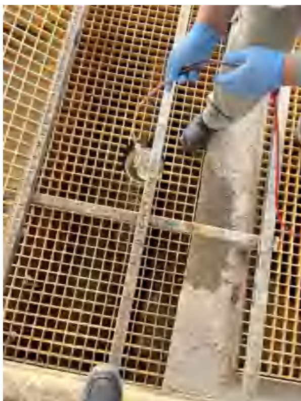
污水处理站 2#进口
